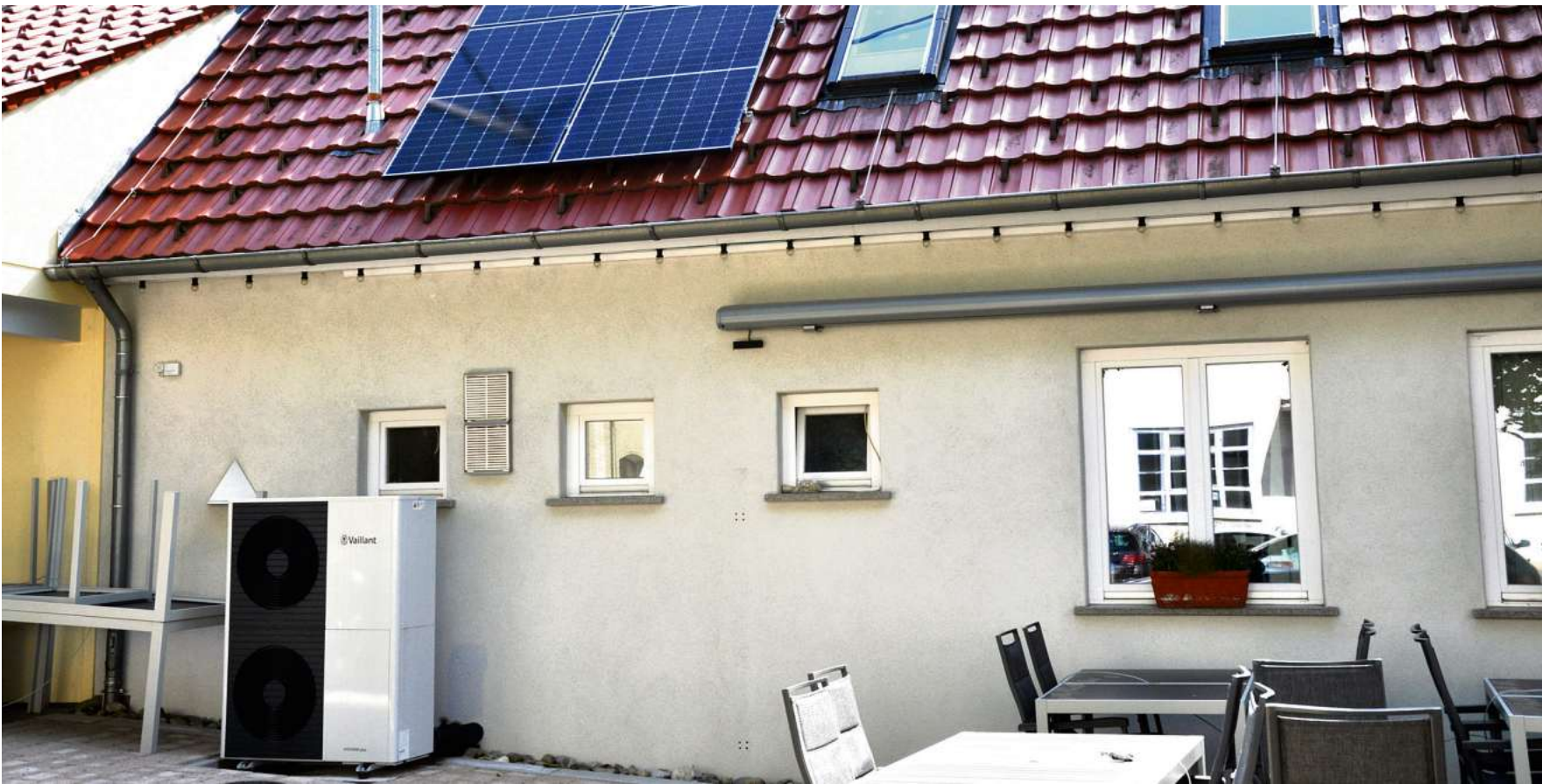
Die Solaranlage auf dem Dach und die Wärmepumpe vor dem Haus. Bei der Sozialstation St. Franziskus sind Digitalisierung und Nachhaltigkeit schon umgesetzt. Foto: Wolff
